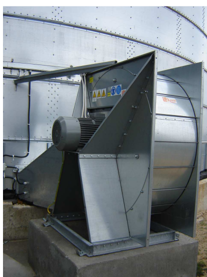
Foto 3. Widok wentylatora przewietrzającego.
